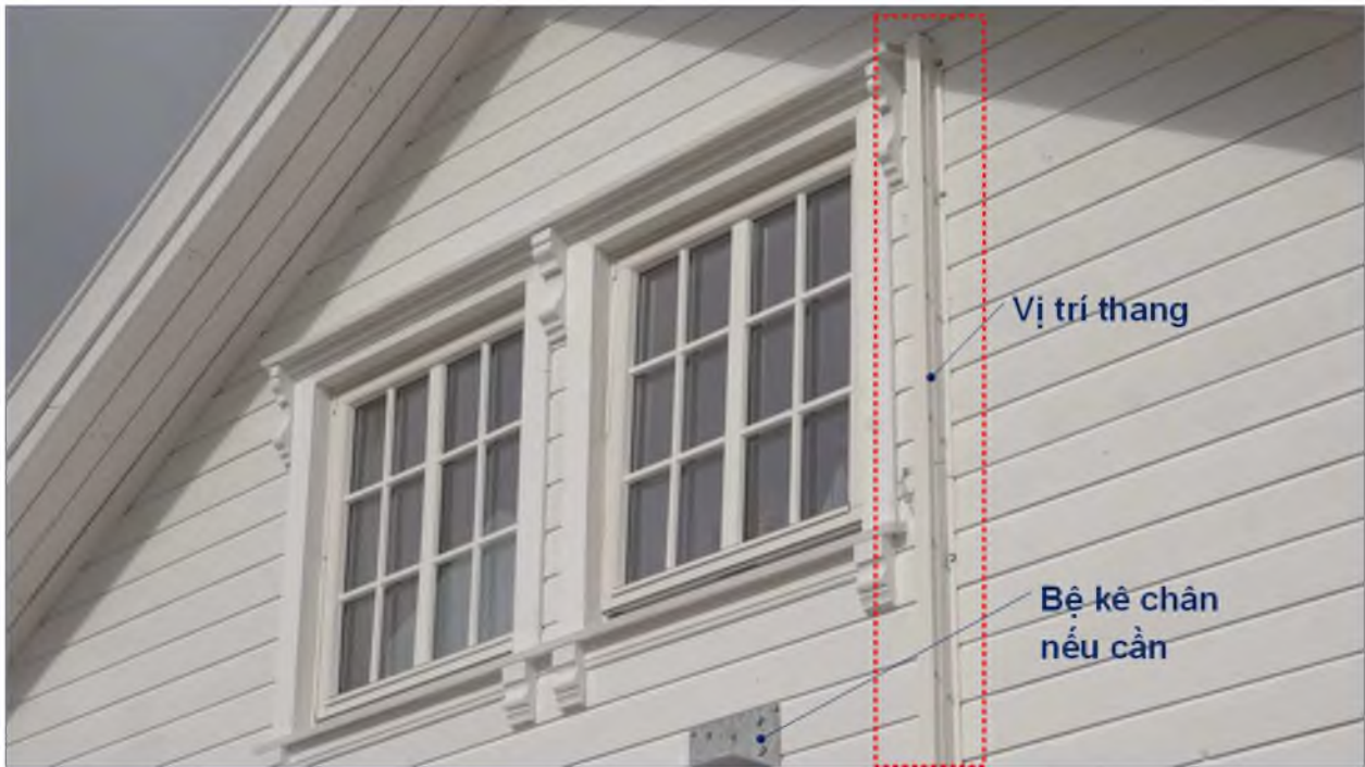
Thang ở trạng thái xếp dọc, ép sát bề mặt tường (vị trí lối ra khẩn cấp trên cùng)
