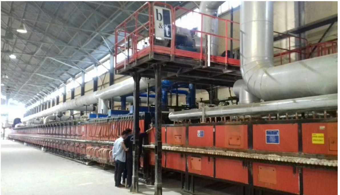
Hình 7: Hệ thống lò nung thanh lăn
