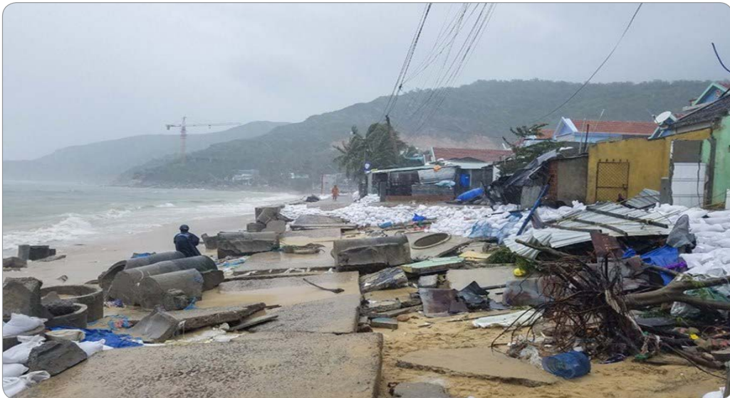
Hình 6.5. Bờ kè biển chắn sóng Nhơn Hải, TP. Quy Nhơn bị hư hỏng sau cơn bão số 5 năm 2019 (Nguồn: Báo Bình Định)
