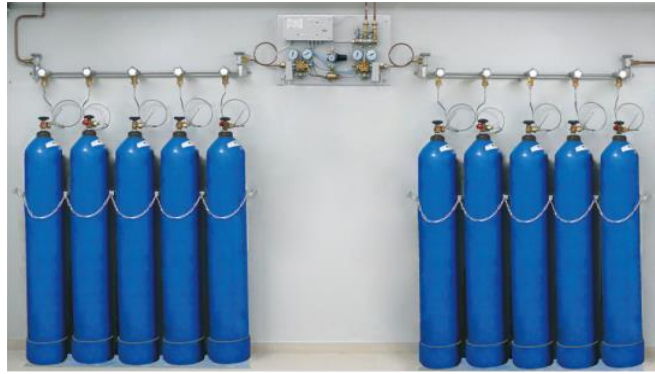
Hình 1.2. Dàn gom (Dàn chai oxy)
