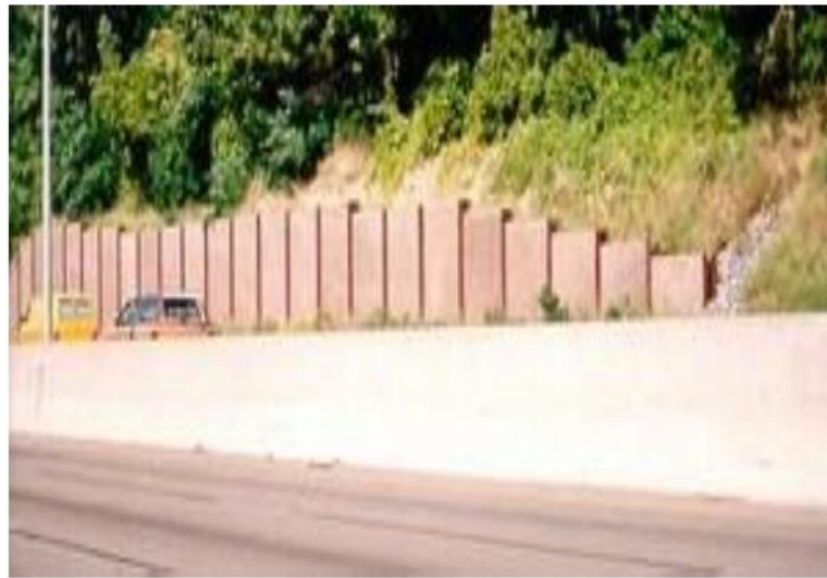
Hình 89 – Xử lý điểm kết thúc tường chống ồn: Chôn xuống đất (minh họa)
