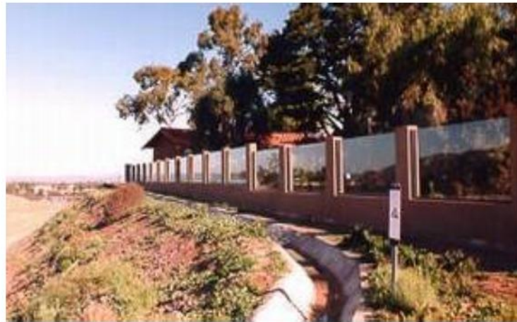
Hình 103 – Thoát nước: Rãnh thoát nước chảy dọc theo tường chống ồn (minh họa)
