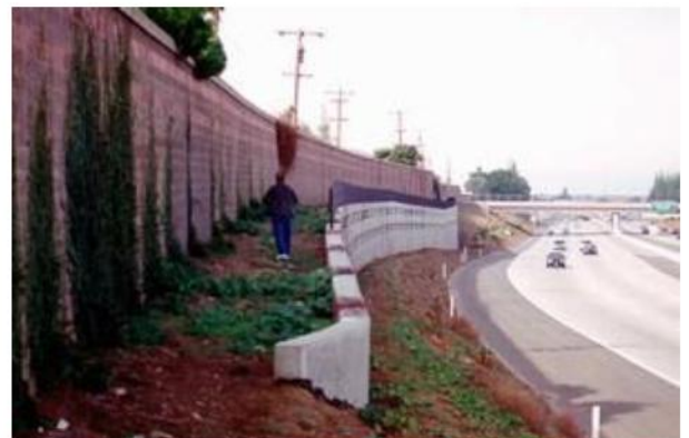
Hình 68 – Tường chống ồn phía sau tường chắn đất đúc tại chỗ (minh họa)
