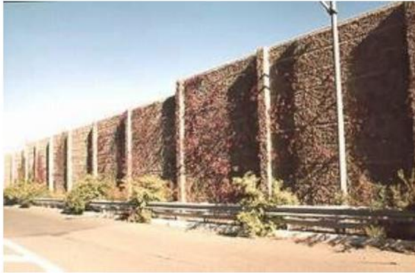
Hình 127 – Bảo vệ tường chống ồn khô và chạm với dòng xe (minh họa)
