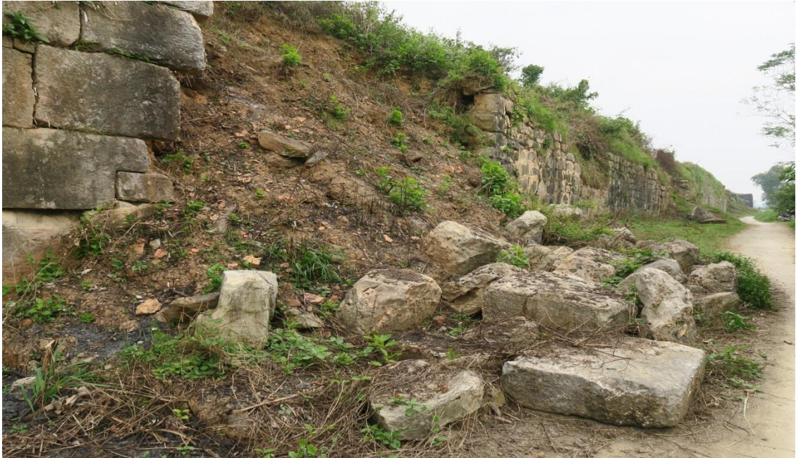
Tình trạng sạt lở do bão của một đoạn tường thành phía Bắc
