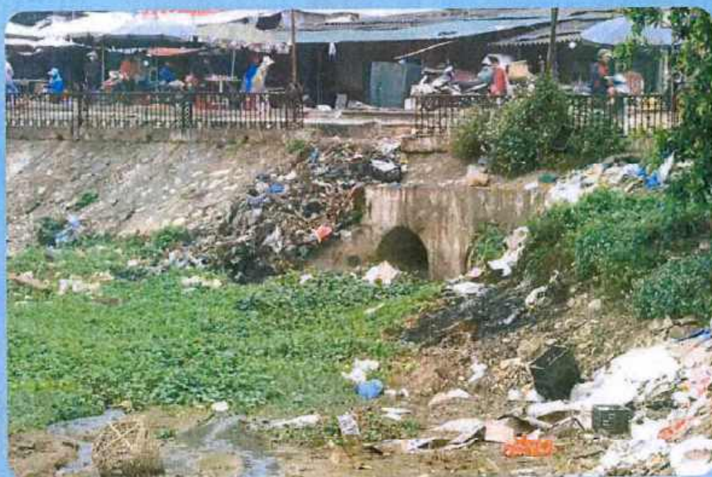
Hình 3. Xả nước bẩn tại khu vực bờ kè sông Nậm Rốm gây ô nhiễm môi trường
